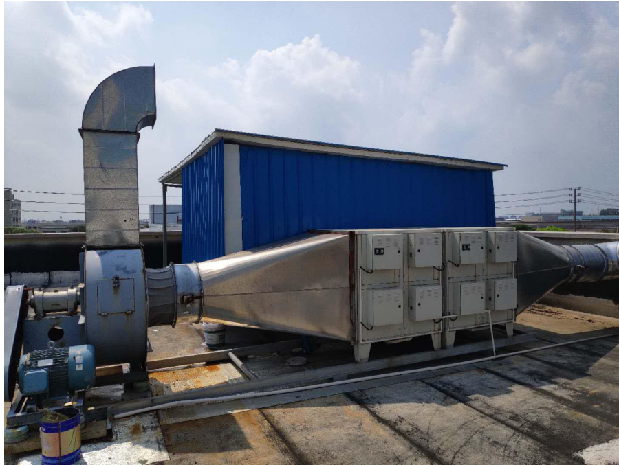
图 4-3 有机废气处理设施
