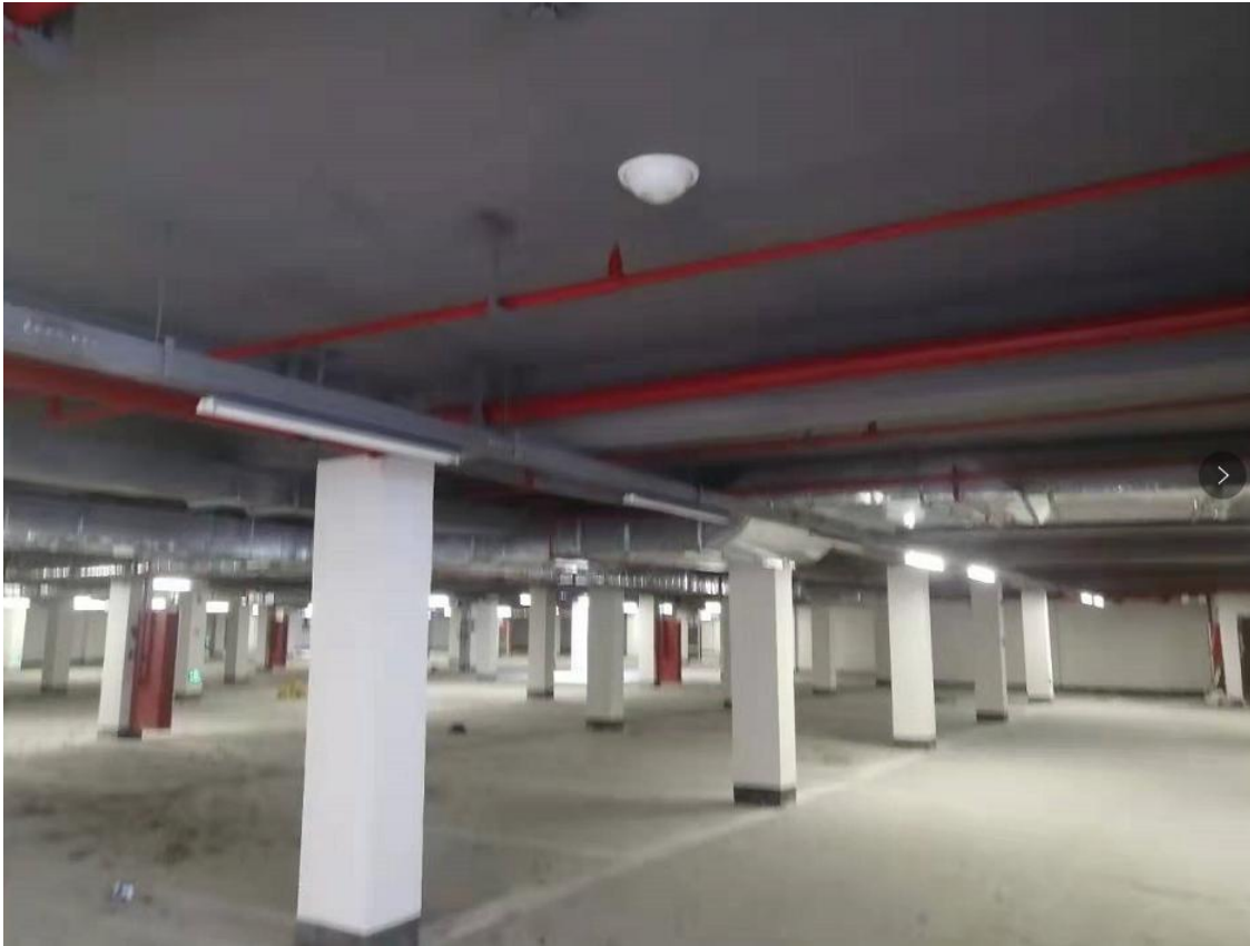
地下车库消防管
