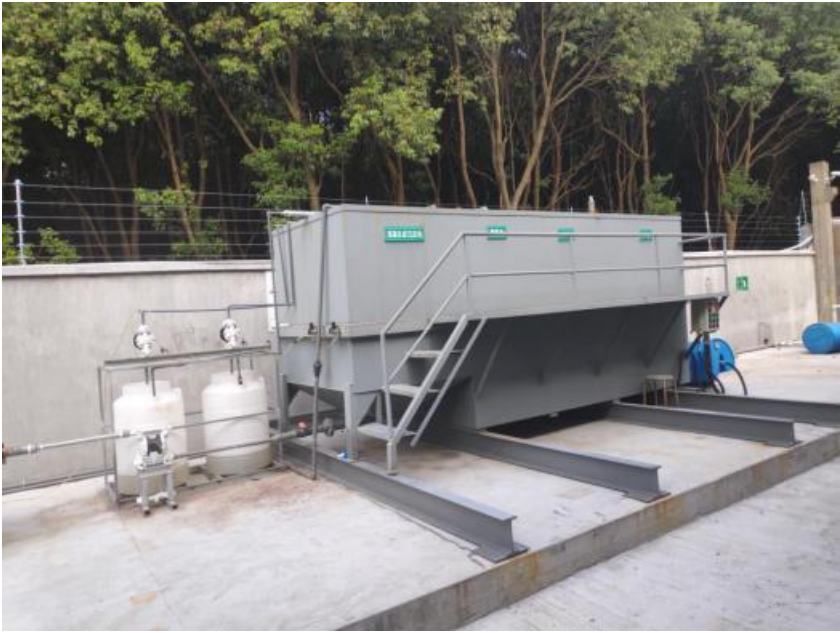
图 4-2 废水治理设施
