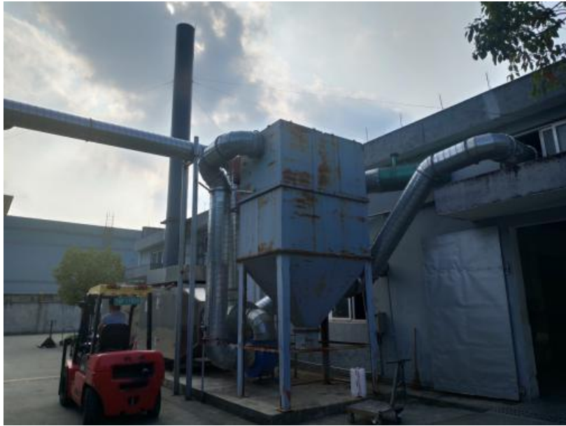
图 4-5 废气治理设施
