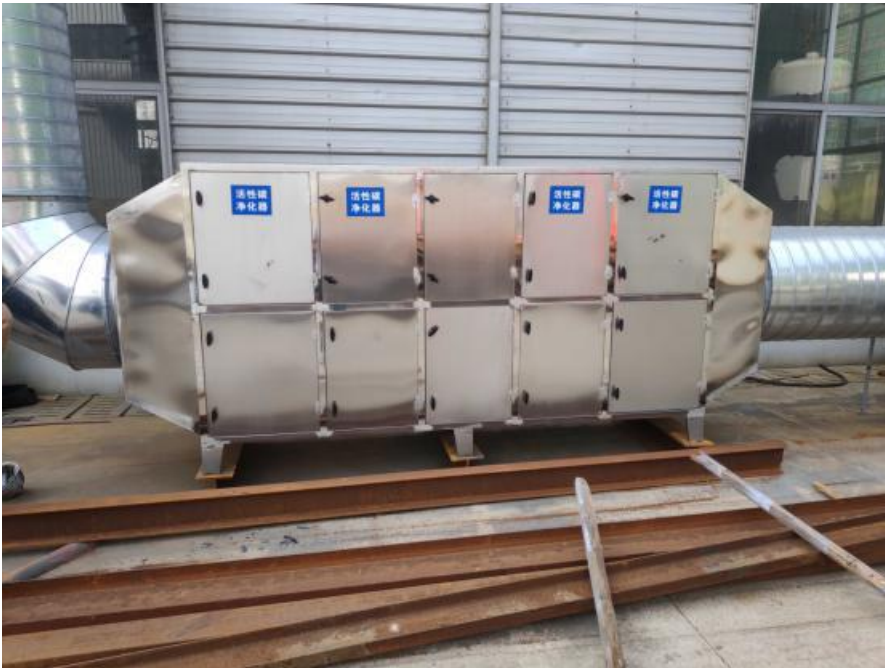
图4-4 废气处理设施
