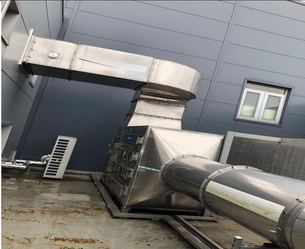
图 4-4 废气处理设施 干式过滤器+低温等离子+活性炭吸附塔
