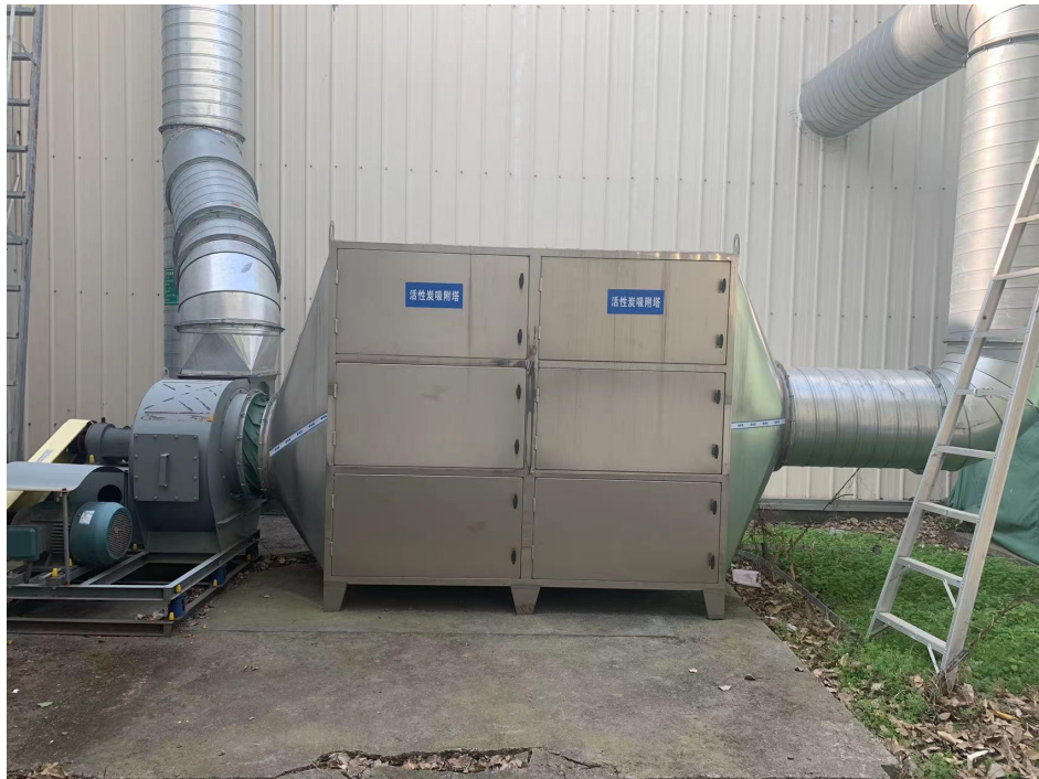
图 4-4 注塑废气处理设施
