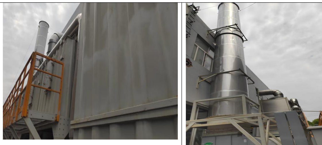
废气处理设施照片
